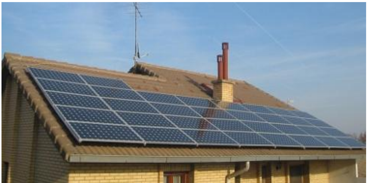
Figura 10. Ejemplo de instalación fotovoltaica en tejado.
