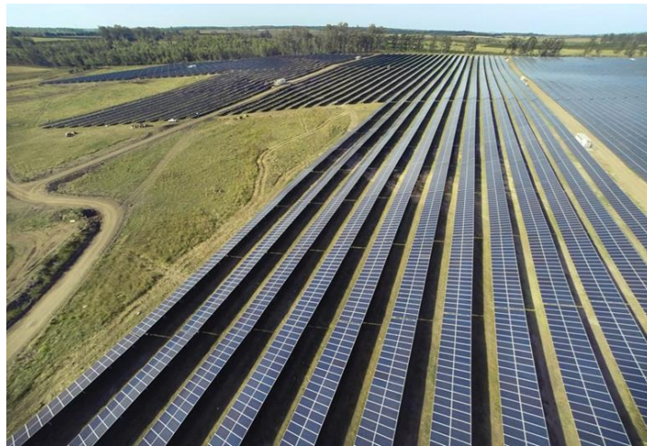
Ilustración 19: Distribución similar de los paneles solares en el terreno de la instalación Guillena.
