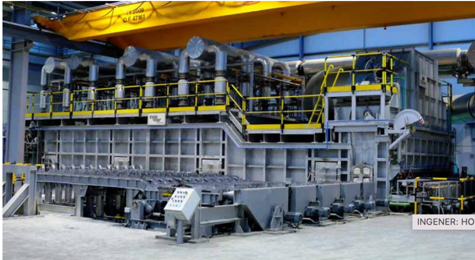
Figura 10. Horno de recalentamiento de vigas galopantes [Walking Beam]
