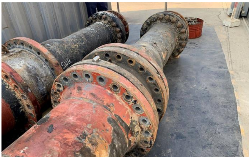
Figura 2.18. Tuberías oxidadas de una planta de refino [7]
