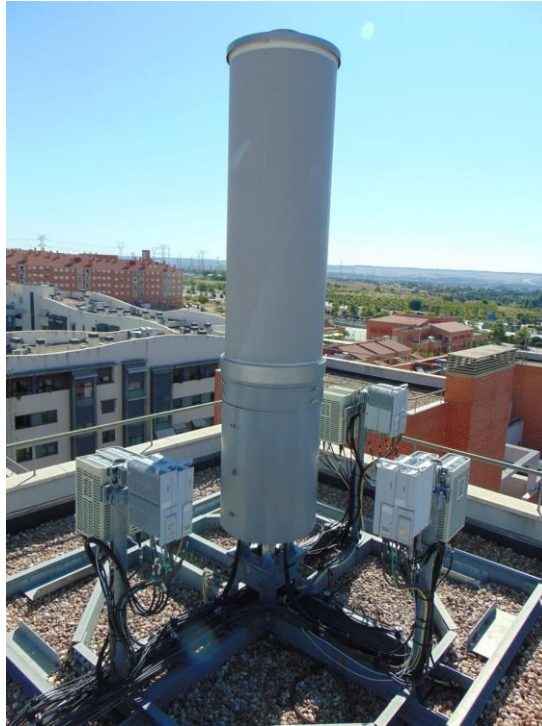
Figura 33. Mimetizado SLIM en cuyo interior se encuentran las antenas.
