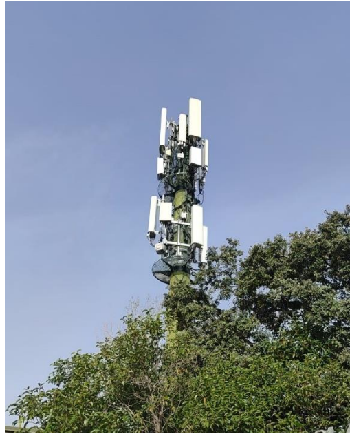
Figura 18. Sistema radiante en lo alto de una torre tubular.
