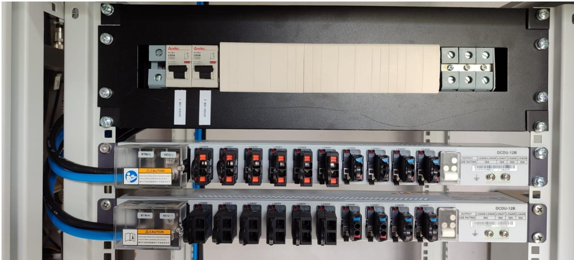
Figura 30. Vista de 2 DCDU-12B alimentadas por 1 disyuntor de 100 A respectivamente.
