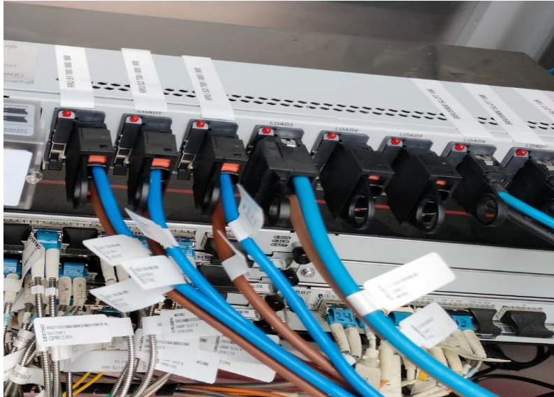
Figura 41. Etiquetado de fibras ópticas y alimentaciones.
