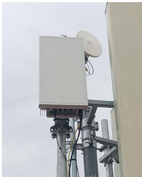
Figura 23. Imagen de una antena activa 5G.
