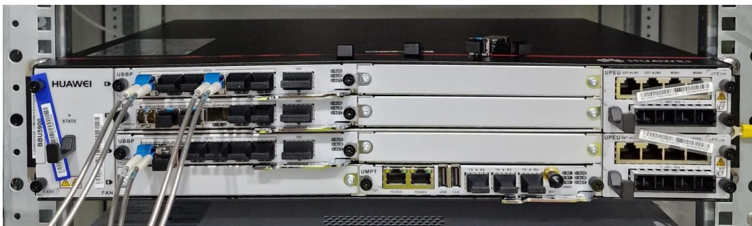
Figura 29. Vista de una BBU5900 con tarjetería UBBP y UMPT insertada y fibras ópticas conectadas.
