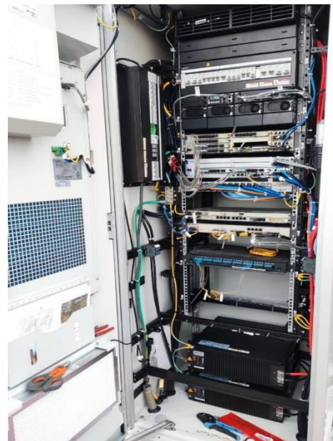
Figura 35. Vista de equipos que alberga el TP48400.
