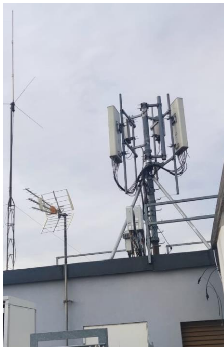
Figura 17. Sistema radiante en la azotea de un edificio.
