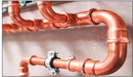
Ilustración 2. Tubería de cobre en red interior.
