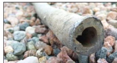
Ilustración 27. Tubería de plomo.
