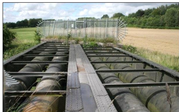
Ilustración 1. Cuatro tuberías de hierro fundido de 36 pulgadas. [8]
