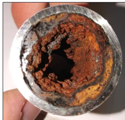
Ilustración 23. Incrustaciones de corrosión en el interior de una tubería de acero galvanizado de agua fría tras 30 años de servicio.
