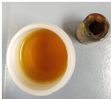
Ilustración 40. Agua estancada durante siete días en el interior de la sección de la tubería mostrada en la imagen.
