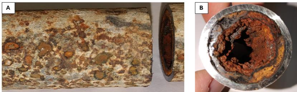
Ilustración 39. Imágenes de la corrosión de la tubería. A) Zona exterior. B) Zona interior.
