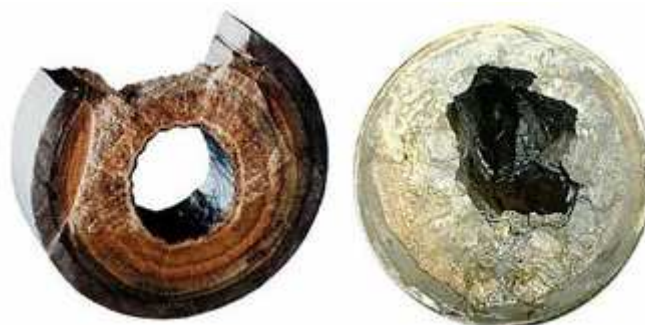
FIGURA 2. Sección transversal de dos tuberías en las que ha tenido lugar la deposición de sales inorgánicas
