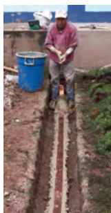
Figura 16.4.: Pozo de Puesta a Tierra.
