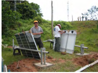
Figura 16.11.: Fijación de paneles fotovoltaicos en tierra.
