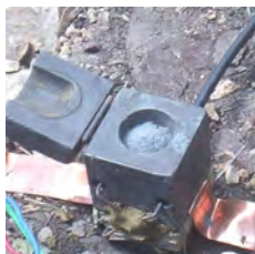
Figura 16.7.: Molde para la aplicación de soldadura exotérmica entre el fleje y el cable de cobre.
