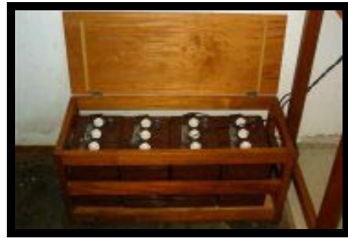
Figura 8.- Baterías que alimentan los equipos EHAS.
