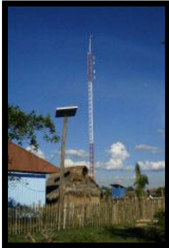
Figura 7.- Paneles solares que alimentan un PS.
