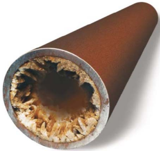
Figura 1: Scales en tubería (Cabtree et al., 1999)
